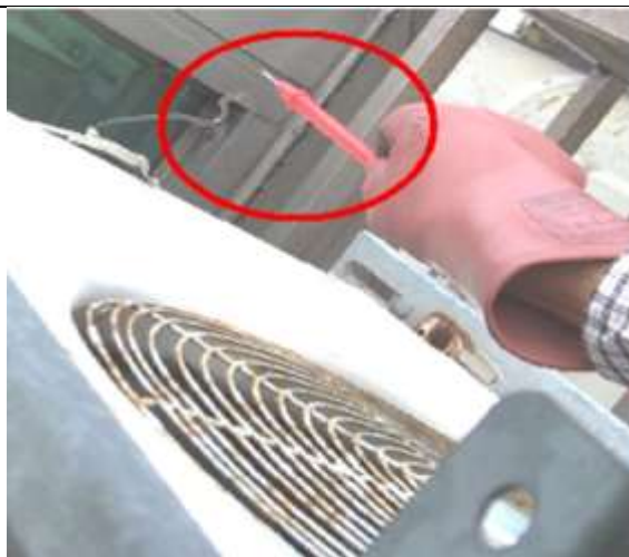
檢測之電線裸露情況
